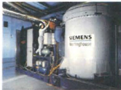
Εικόνα 3.7: Μονάδα συμπαραγωγής SOFC 220 kW ,εγκατεστημένη στο πανεπιστήμιο της Καλιφόρνια.
