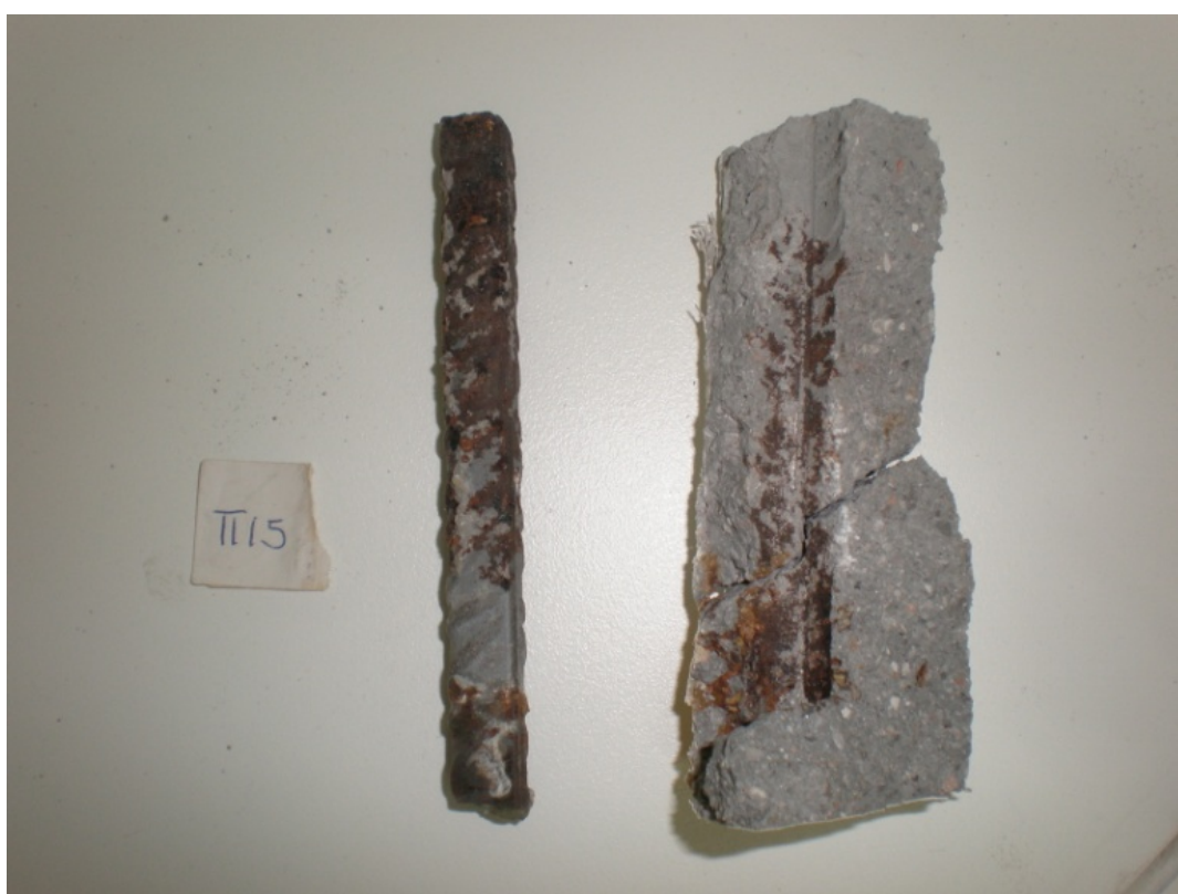
Φωτογραφίες 8,9. Οι σπλισμοί σκυροδέματος πριν τον καθαρισμό τους
