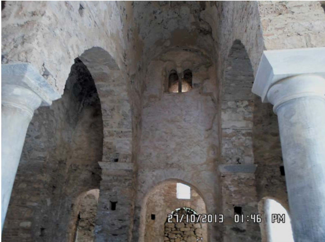
Εικ.59: Ο τρούλος του στηρίζεται Δυτικά σε δύο κίονες. Πηγή: Γαλανού Κατερίνα
