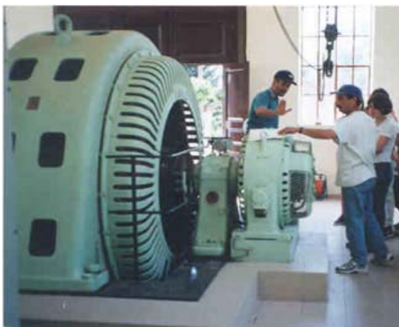
Εικόνα Π.1.4 : Γεννήτρια Υ/Η Σταθμός Γλαύκου
