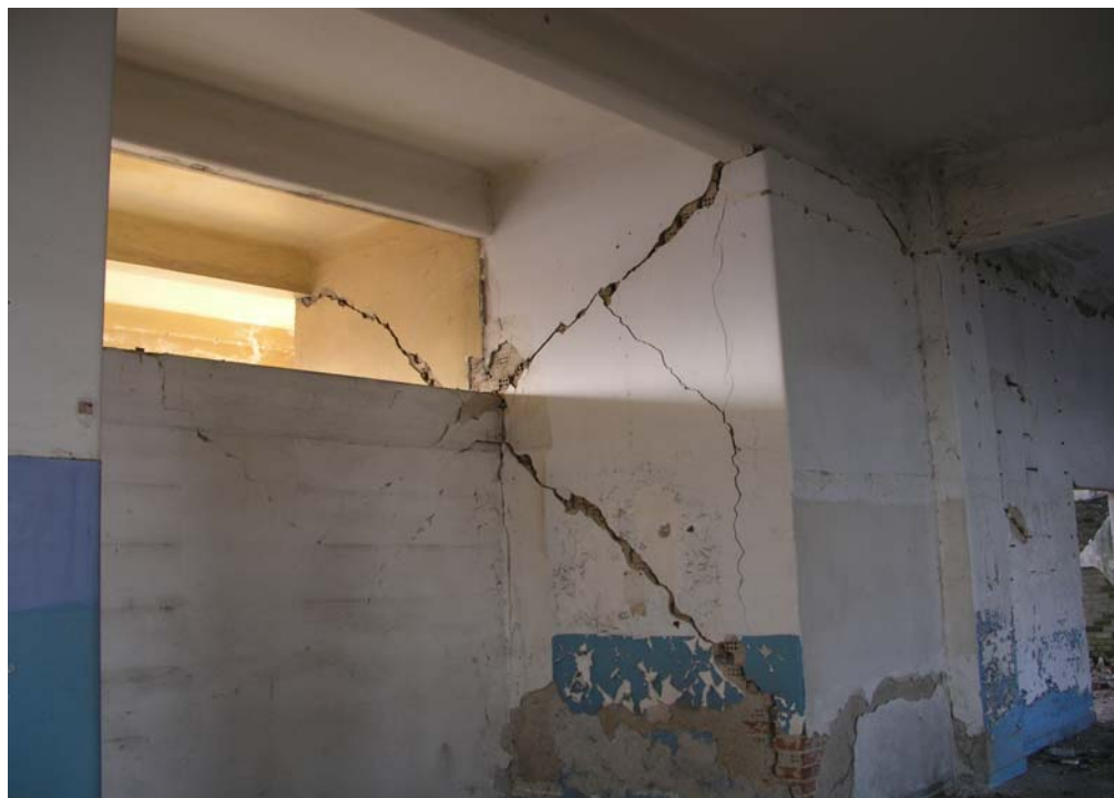
Εικόνα Π.Β.3 : ρωγή σε εσωτερική τοιχοποιία στον 1 ο όροφο
