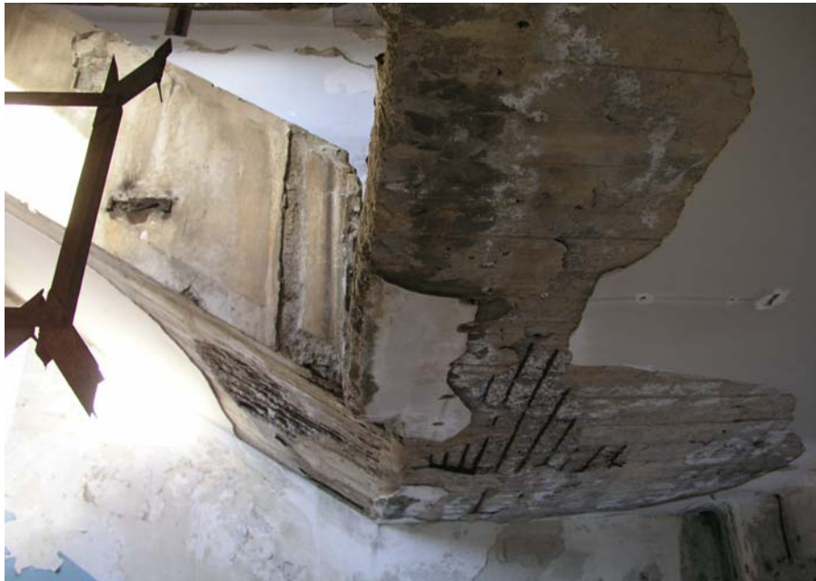
Εικόνα III.B.2.1 : εμφάνη σίδερα στο κάτω μέρος της σκάλας
