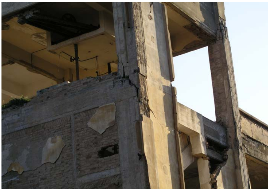
Εικόνα III.B.2.2 : ρηγμάτωση των υποστυλωμάτων της κλίμακας
