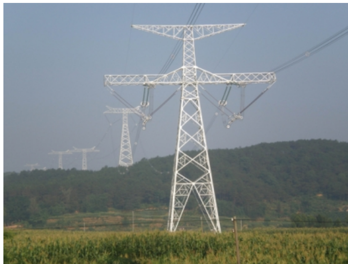
Σχήμα 3.8 Πυλώνες μεταφοράς HVDC
