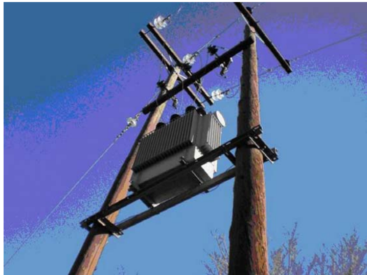
Σχήμα 1.3 Μετασχηματιστής Υποβιβασμού 20KV/0.4KV
