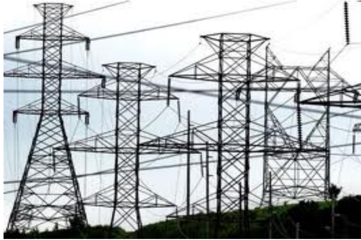
Σχήμα 1.2 Πυλώνες Υπερυψηλής Τάσης
