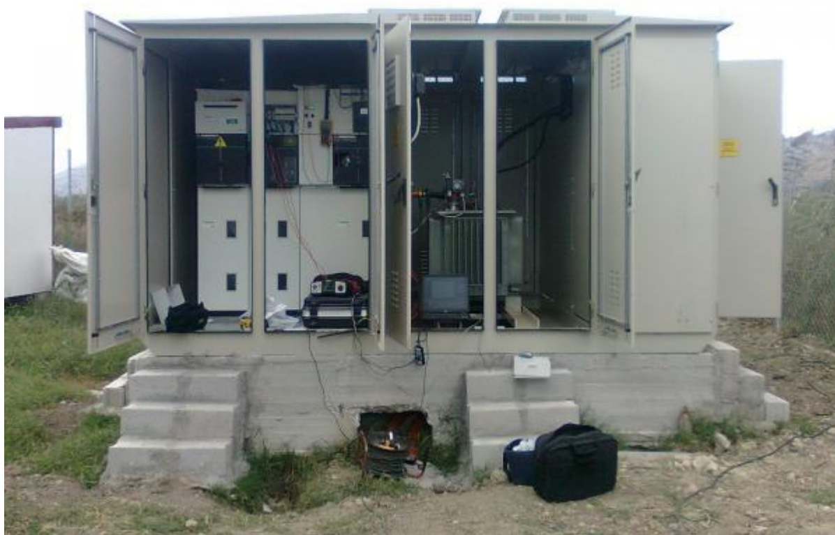
Εικόνα 2.2 Επίγειος Υποσταθμός Μ.Τ.
