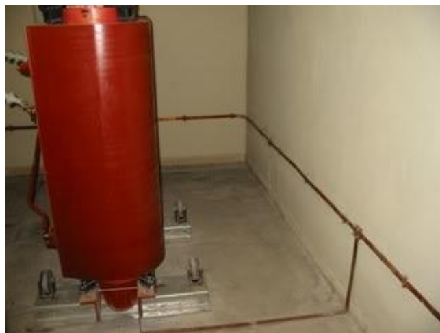
Εικόνα 2.19 Γείωση χώρου Μετασχηματιστή
