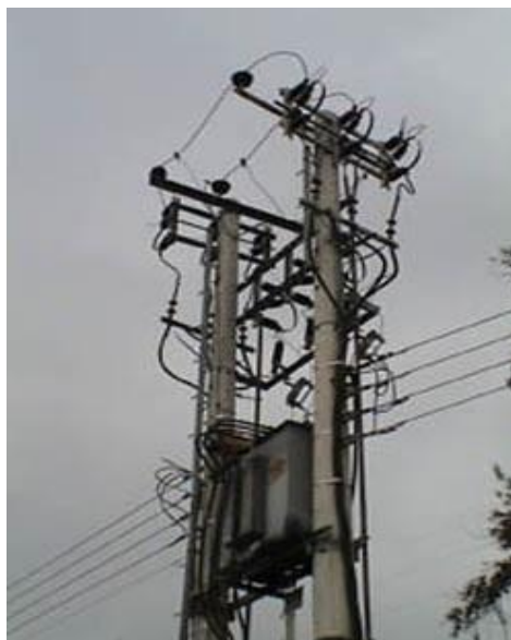
Εικόνα 2.1 Εναέριος Υποσταθμός Μ.Τ.
