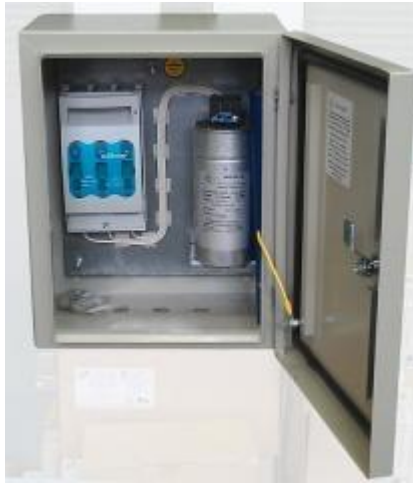
Εικόνα 2.21 Κεντρική αντιστάθμιση Υποσταθμού
