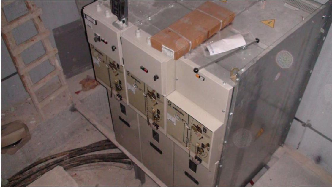
Εικόνα 2.3 Υπόγειος Υποσταθμός Μ.Τ.
