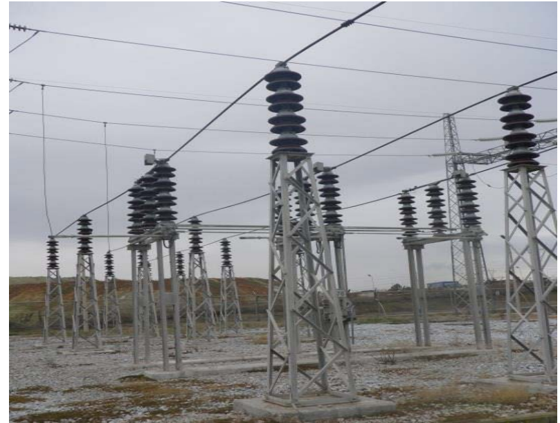
Αποζεύκτες και γειωτές Υποσταθμού
