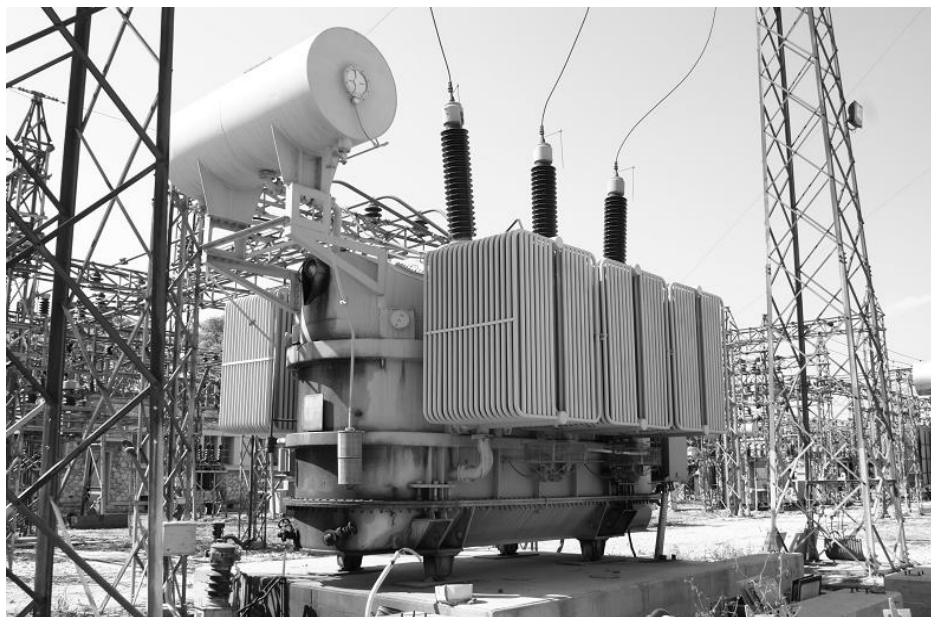
Σχήμα Ошибка! Используйте вкладку "Главная" для применения StyleHeading 1 к тексту, который должен здесь отображаться..1 : Μετασχηματιστής με μονωτικά λάδια [ΔΕΗ Α.Ε.]
