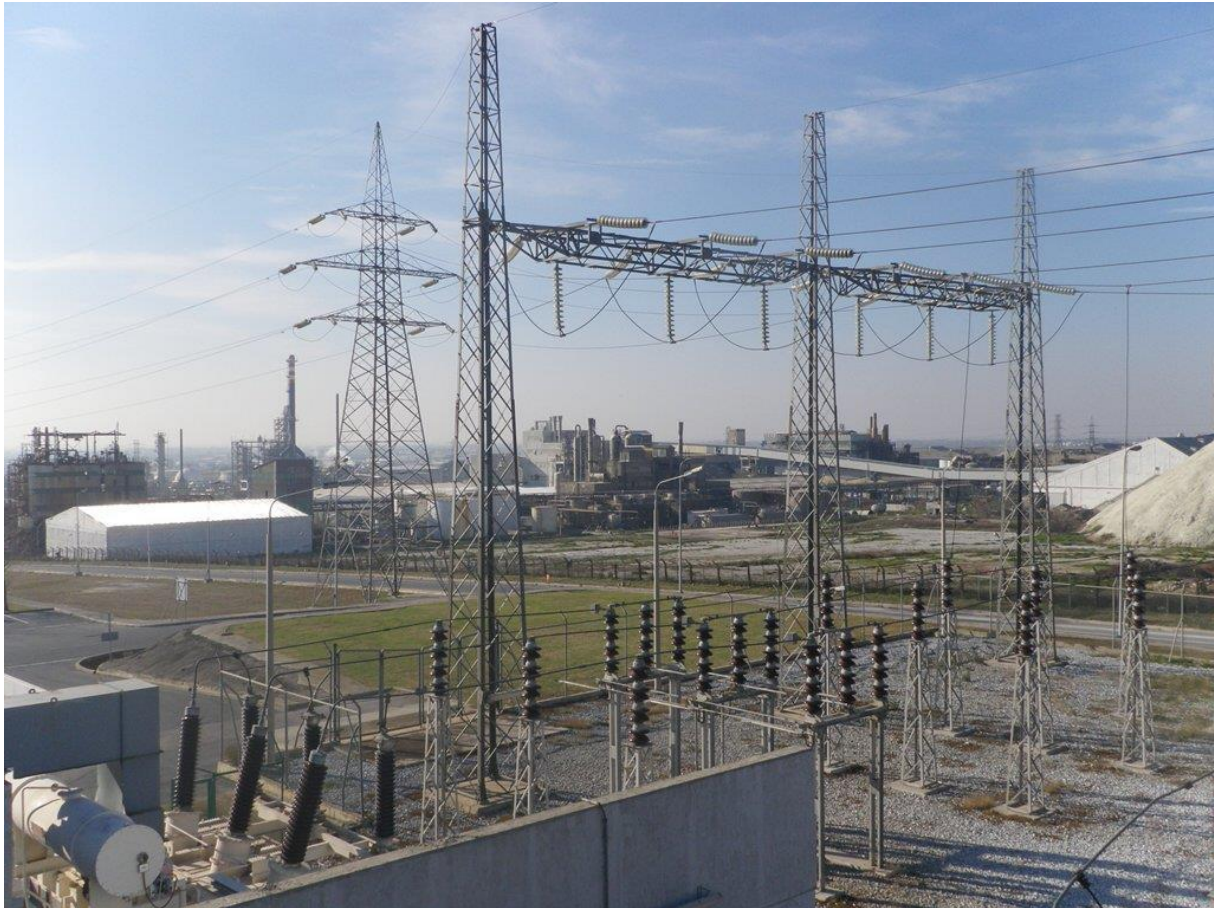
Σχήμα 2.3 : Υπαίθριος Υποσταθμός 150kV Βιομηχανικής Μονάδας Πολυπροπυλενίου [6]
