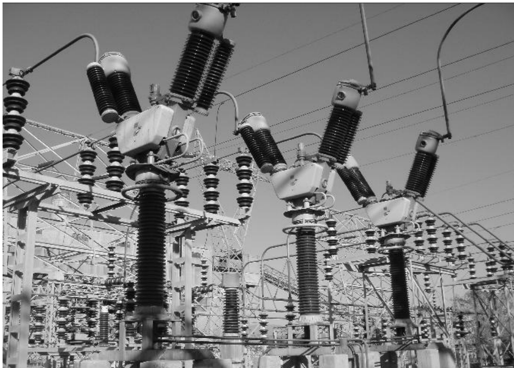
Σχήμα Ошибка! Используйте вкладку "Главная" для применения StyleHeading 1 к тексту, который должен здесь отображаться..2 : Διακόπτες Λαδιού (Πηγή : ΔΕΗ ΑΕ)
