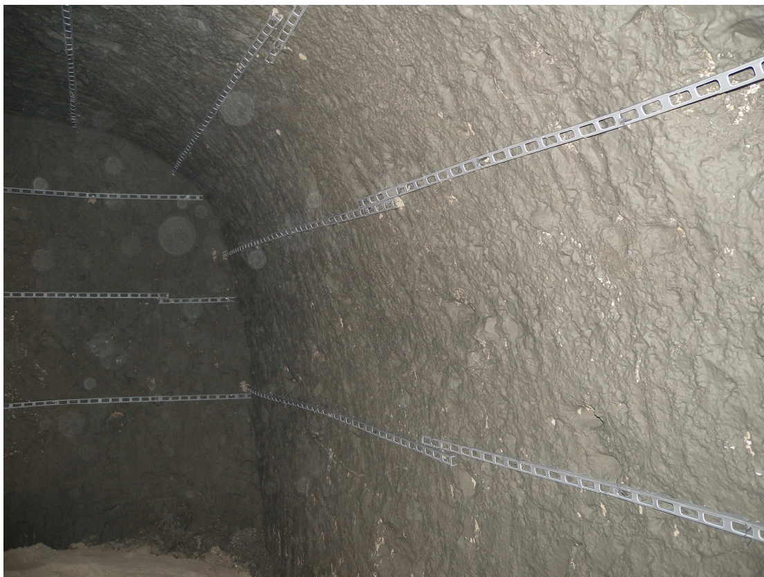
Εικ. 19: Επέμβαση για την ενίσχυση του εσωτερικού του υπόσκαφου. 1ο στάδιο (Πηγή: Προσωπικό αρχείο Αρχιτέκτονα Σταύρου Κουταλίδη )
