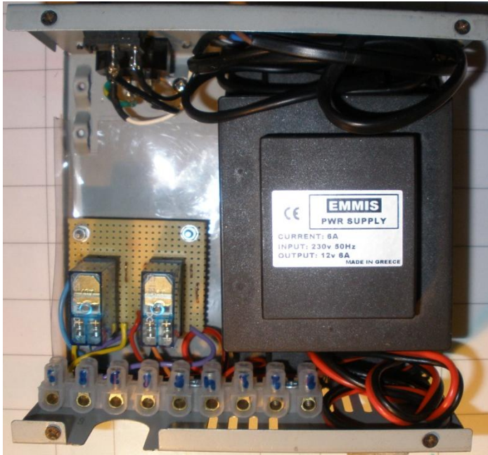
Τροφοδοτικό και ρελέ
