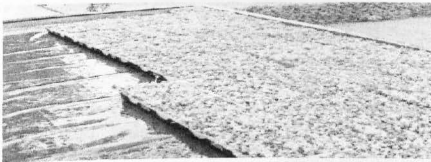
Εικόνα 1: Φυτεμένο δώμα με modular system, πηγή: Αρχείο greenroofs
