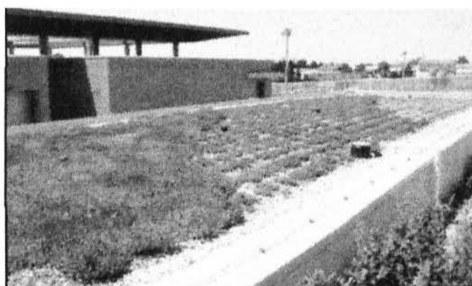
Εικόνα 19: Η ολοκληρωμένη υποδομή, προστατεύει την μεμβράνη στεγανοποίησης και αυξάνει την διάρκεια ζωής.
