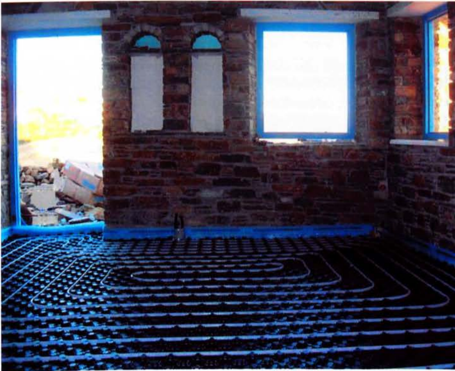
Σχήμα 9: Παράδειγμα εγκατάστασης ενδοδαπέδιου δροσισμού
