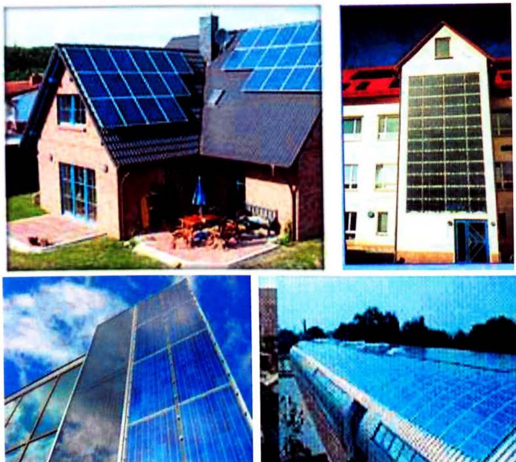
Σχήμα 35: Εγκαταστάσεις Φ/Β συστημάτων σε κτιριακές εγκαταστάσεις
