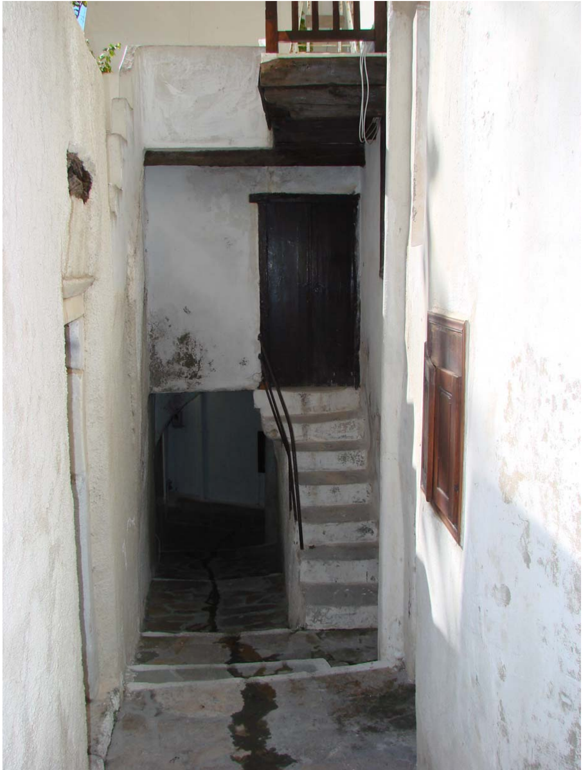
Εικ.26- Στεγαστό ορθογωνικής όψης όπου συνδέεται άμεσα με τη σκάλα του σπιτιού
