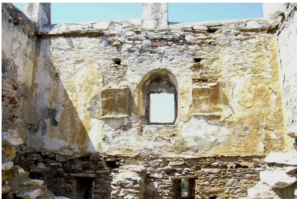
Εικ.46- Το εσωτερικό του Πύργου κατεστραμμένο από την πυρκαγιά
