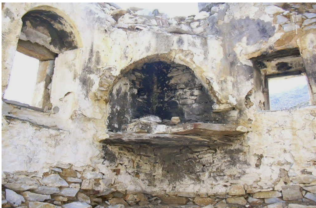
Εικ.45- Το εσωτερικό του Πύργου κατεστραμμένο από την πυρκαγιά
