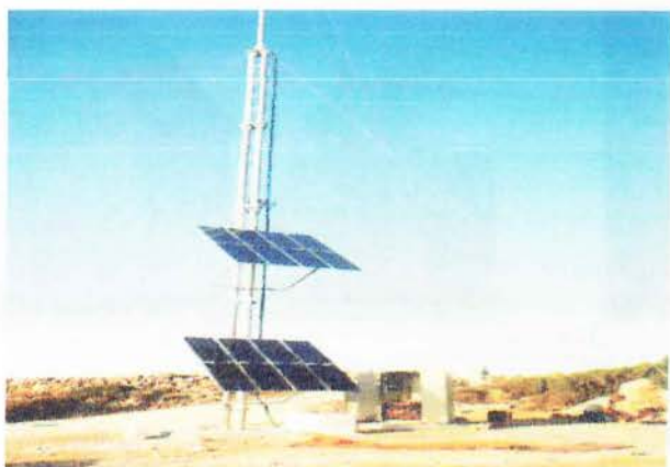
Φ/Β σύστημα για τις ανάγκες ηλεκτροδότησης Α/Δ της Vodafone στη Σύρο
