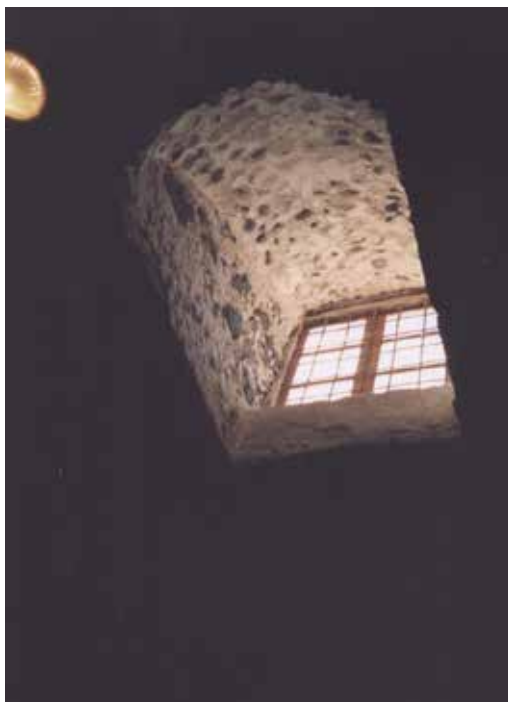
εικ.12 Ανεμολδός, χρησιμεύει για αερισμό της κάναβας κατά τις μέρες του πατήματος των σταφυλιών.
