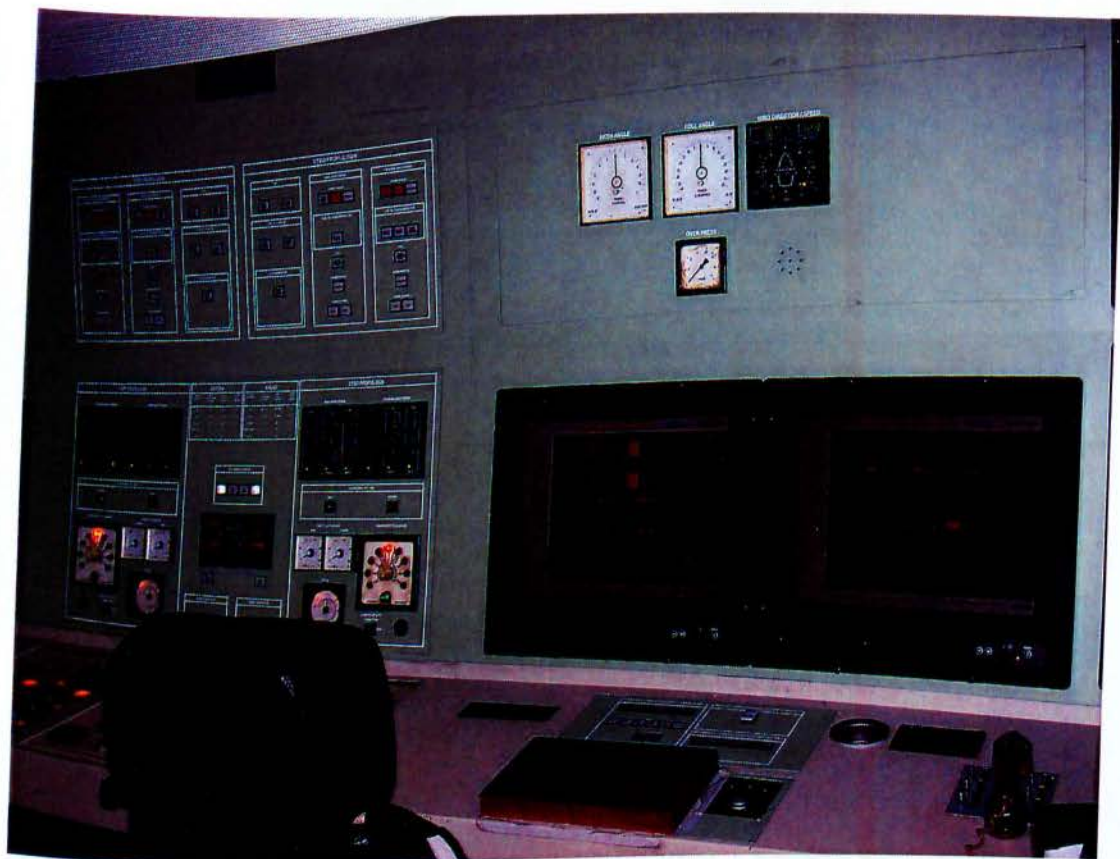
Εικόνα 6.3.2.1.5: Απεικόνιση Σταθμού Εργασίας Χειρισμού στην γέφυρα του πλοίου. (Φαίνονται πιο ξεκάθαρα πλέον τα μιμικά διαγράμματα εδώ)
