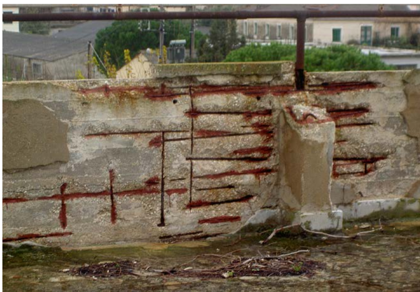
Εικόνα 51. Διάβρωση στο στηθαίο του Δώματος. Διακρίνεται ο πρόχειρος τρόπος προστασίας του οπλισμού με αντιδιαβρωτικό χρώμα που όμως δεν είναι ικανό να παράσχει την αναγκαία προστασία.
