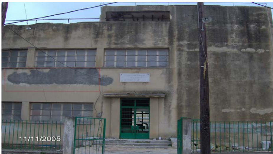
ΕΙΚΟΝΑ 45. Α' Δημοτικό. Διακρίνεται η προσπάθεια επιδιόρθωσης των επιχρισμάτων για να περιοριστεί η διάβρωση του οπλισμού.
