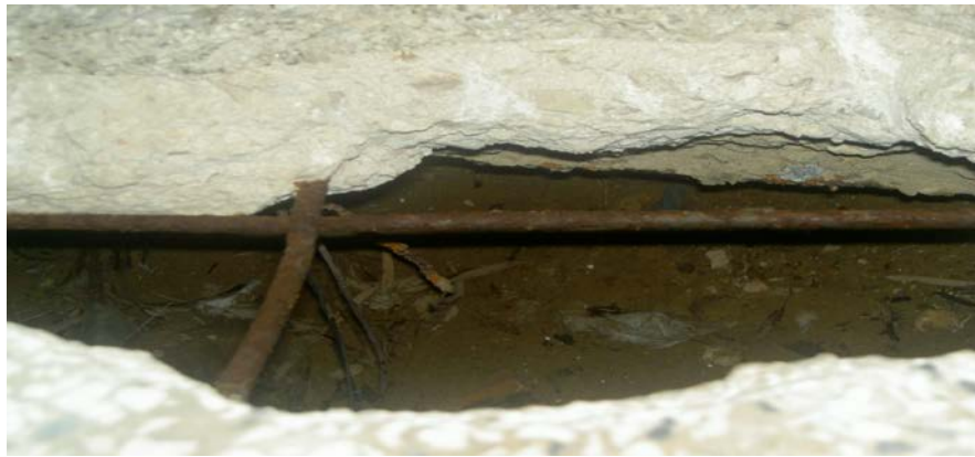
Εικόνα 48. Από το δάπεδο του ισογείου. Δακρίνεται ο οπλισμός διαβρωμένος σε μεγάλο βαθμό.
