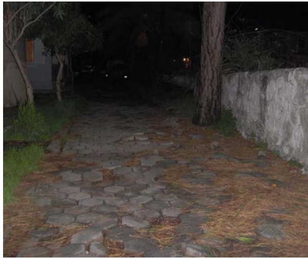
Εικόνα 139. Κατεστραμμένο τμήμα πεζοδρόμου
