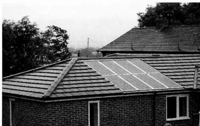
Εικόνα 41: Φωτοβολταϊκό πλαίσιο με απευθείας τοποθέτηση
