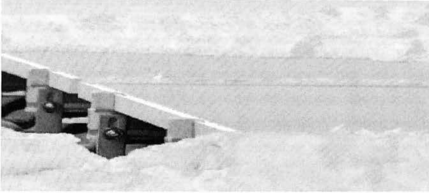
Εικόνα 30: ΦΒ πλαίσια εγκατεστημένα σε κεκλιμένη οροφή μερικώς καλυμμένα από χιόνι
