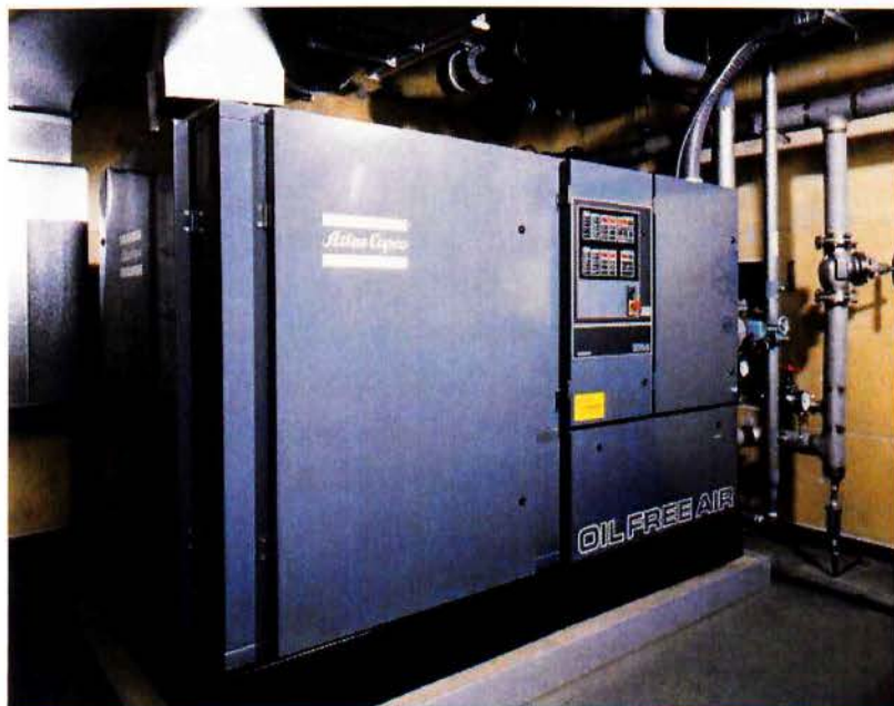
Εικόνα 11: Συγκροτημένη μονάδα παραγωγής πεπιεσμένου αέρα Εγκατεστημένη Παροχή Αέρα
