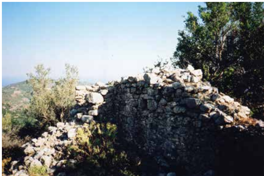
Άλλη άποψη των χαλασμάτων
