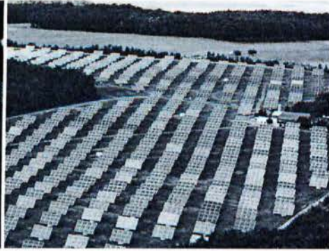
σχήμα 6.11: Φωτοβολταϊκό πάρκο στην Κοζάνη
