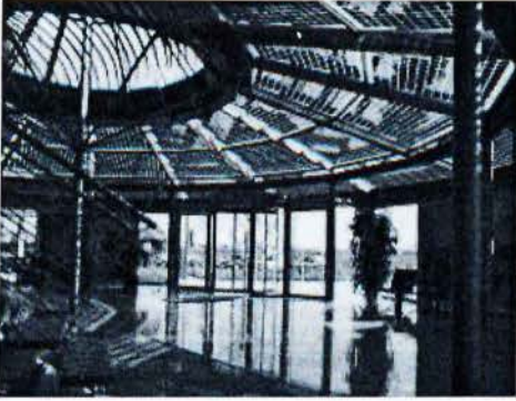
Σχήμα 6.10: Εφαρμογή φωτοβολταϊκών που επιτρέπουν τη διέλευση φυσικού φωτός σε εμπορικό κτίριο
