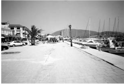
Εικόνα 42. Καθίζηση υλικού επίχωσης. Οδός Γκολέμη.
