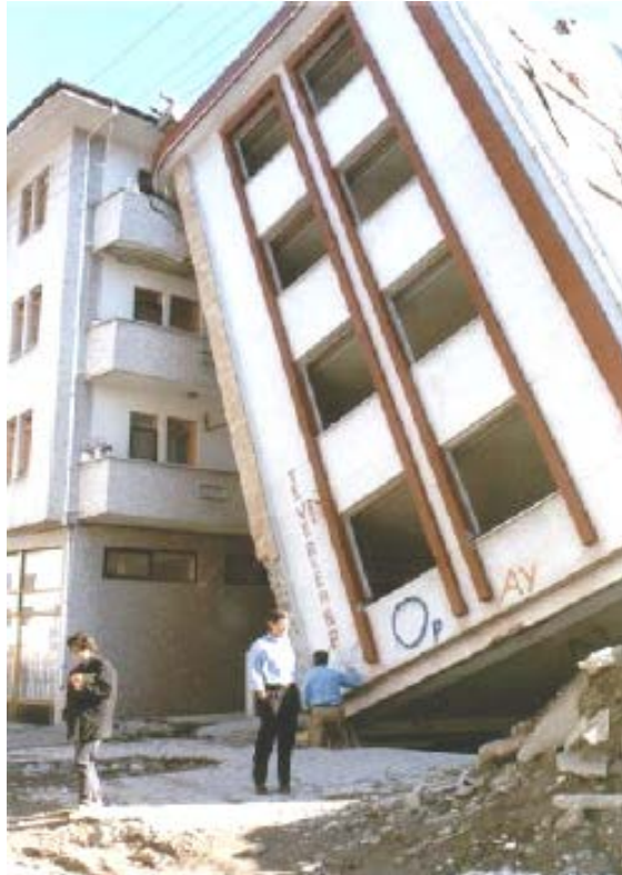
Εικόνα 52. Πλήρης ανατροπή του κτιρίου σε σεισμό στη Τουρκία
