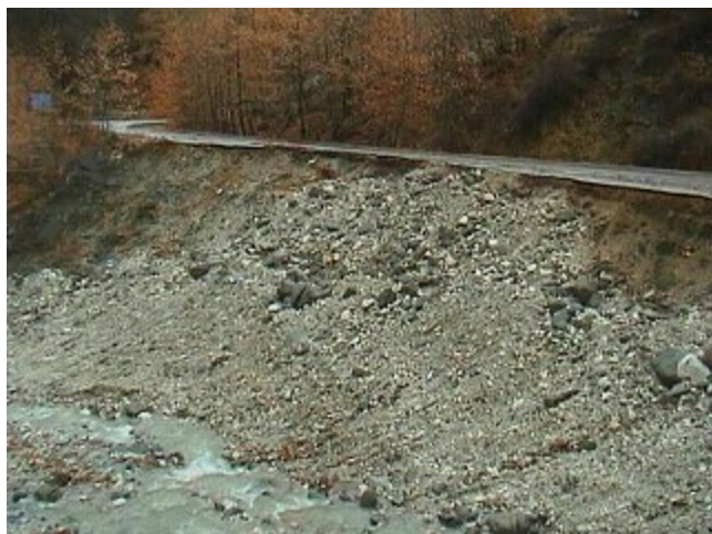
Εικόνα 27. Υποχώρηση του παλιού καταστρώματος από την
