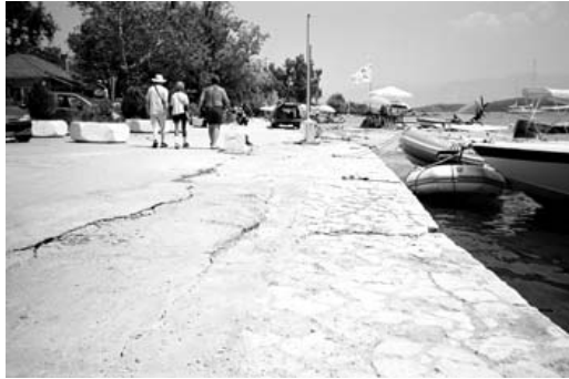
Εικόνα 43. Ρωγμές πίσω από τον κρηπιδότοιχο.
