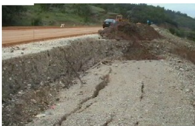
Εικόνα 26. Υποχώρηση του παλιού καταστρώματος από την
