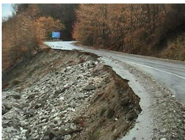
Εικόνα 28. Υποχώρηση του παλιού καταστρώματος από την
