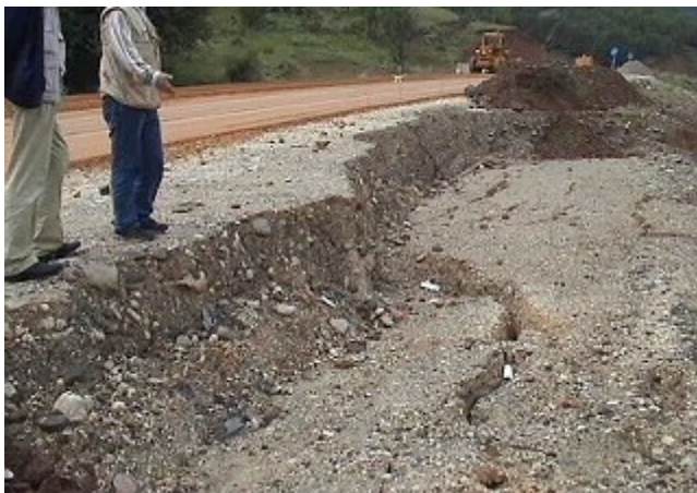
Εικόνα 23. Υποχώρηση του παλιού καταστρώματος από την
