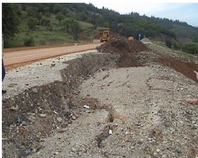
Εικόνα 25. Υποχώρηση του παλιού καταστρώματος από την
