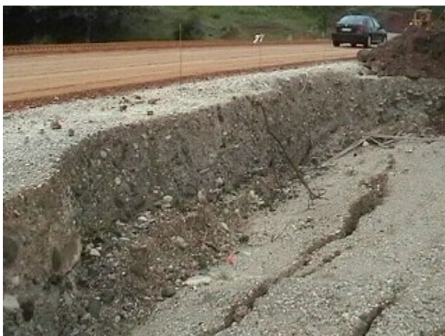
Εικόνα 24. Υποχώρηση του παλιού καταστρώματος από την
