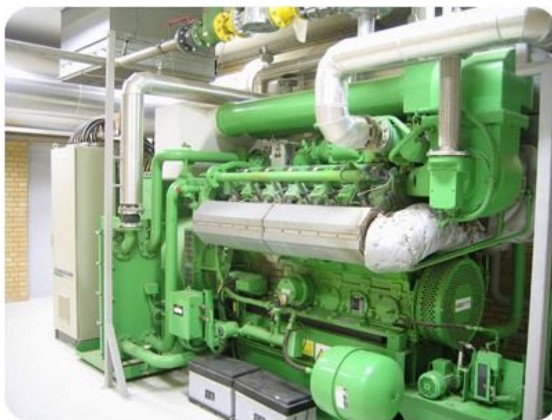
Σχήμα 4.5: Μονάδα Συμπαραγωγής Ηλεκτρικής και Θερμικής Ενέργειας [25]
