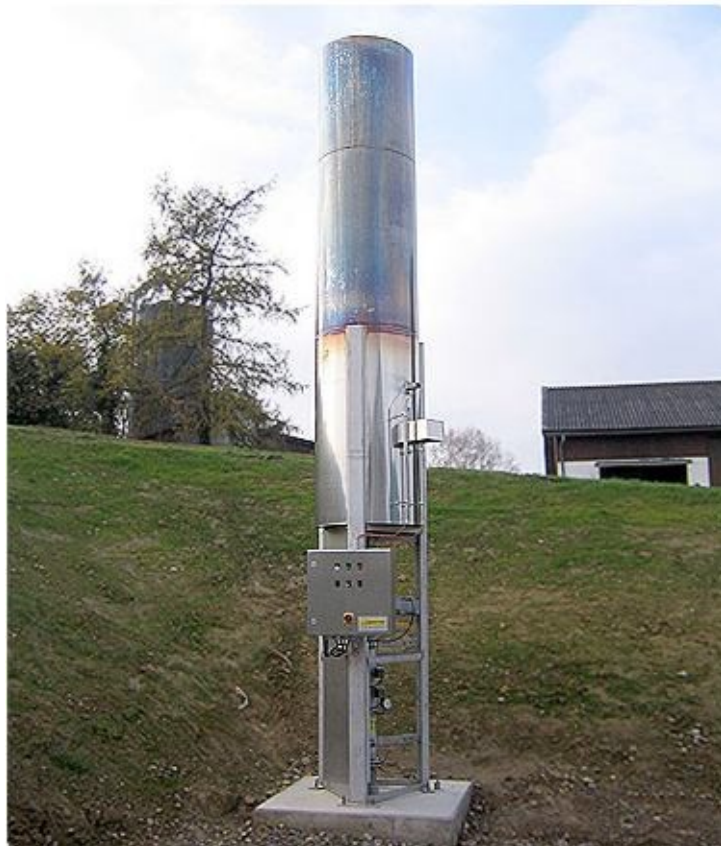
Σχήμα 4.4.: Πυρσός Καύσης Περίσσειας Βιοαερίου [25]
