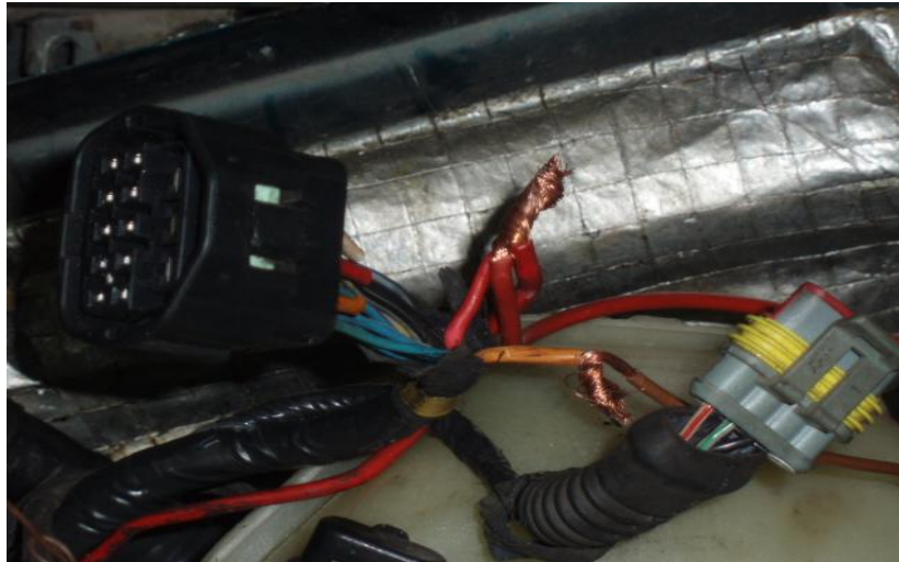
Εικόνα 50: Χειροποίητη κατασκευή καλωδίωσης
