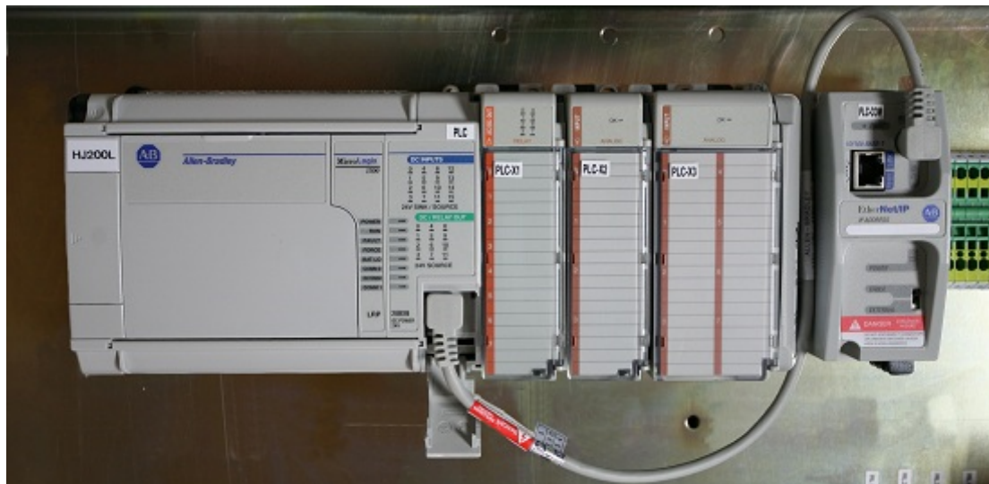
Εικόνα 2 - PLC Allen Bradley
