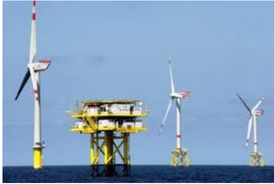
Εικόνα 5.3 υπεράκτιο αιολικό πάρκο
