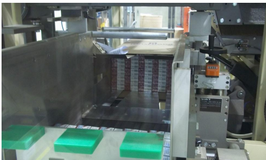
(Εικόνα 2.13): Τα γκρουπάς συγκεντρώνονται στην κούτα, εφόσον αυτή γεμίσει, κλείνει και μεταφέρεται στην παλετοποίηση μέσω ιμάντων μεταφοράς
