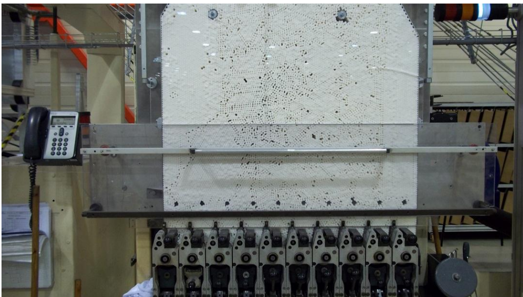
(εικόνα 3.13): Τα φίλτρα συγκεντρώνονται και δρομολογούνται προς στις κατάλληλες μηχανές καπνού (filtromat).
