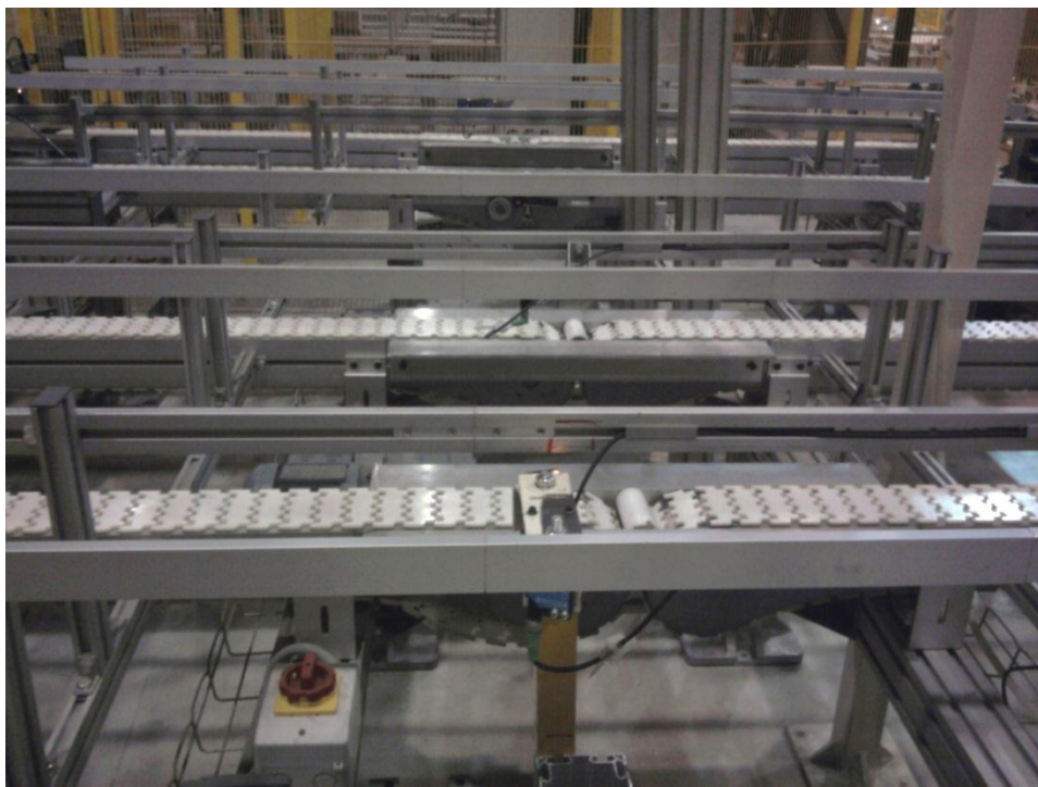
(εικόνα 3.0): Διαδρόμοι εφοδιασμένοι με φωτοκύτταρα ελέγχου όπου οι κούτες έρχονται σηματοδοτημένες από τις μηχανές των εγκιβωτιστικών και ανάλογα το κωδικό barcode που έχουν κολλημένο στο πλάι δρομολογούνται στους παραπάνω διαδρόμους της φωτογραφίας.
