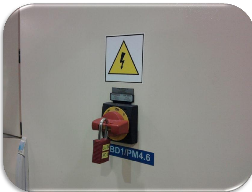
(Εικόνα 4.2): Σήμανση σε ηλεκτρολογικό πίνακα. Η παροχή ρεύματος κλειδωμένη όταν η μηχανή δεν είναι σε λειτουργία.
