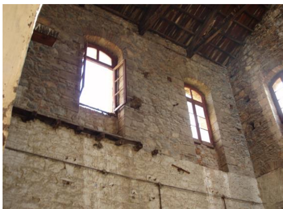
Φωτ.32 - Ό,τι απέμεινε από το δάπεδο του ορόφου του κτιρίου
