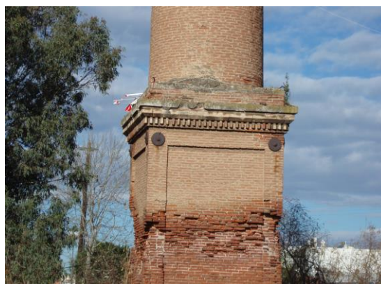
Φωτ.43 – Λεπτομέρεια της καμινάδας
