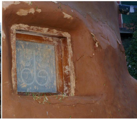
Φθορές στην εξωτερική τοιχοποιία – διάβρωση
