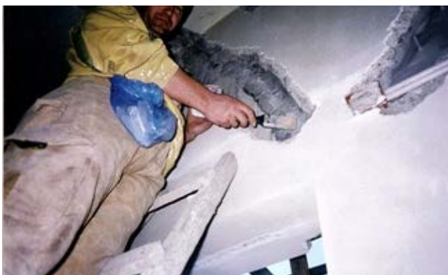
Εικόνα 25 Σφραγίζεται η εκάστοτε ρωγμή με εποξειδική πάστα σε όλο το ανάπτυγμά της
