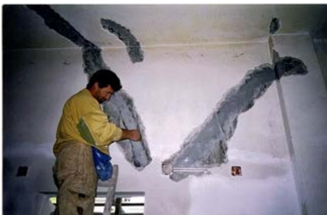
Εικόνα 24 Εφαρμόζονται για συγκολλήσεις ρωγμών οπλισμένου σκυροδέματος που εμφανίζονται κυρίως στα σεισμόπληκτα κτίρια
