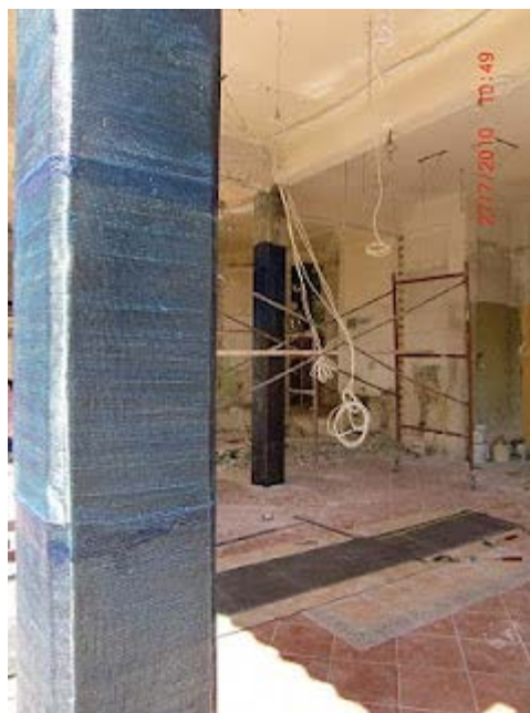
Εικόνα 22 Εξωτερικής περίσφιγξη με frps
