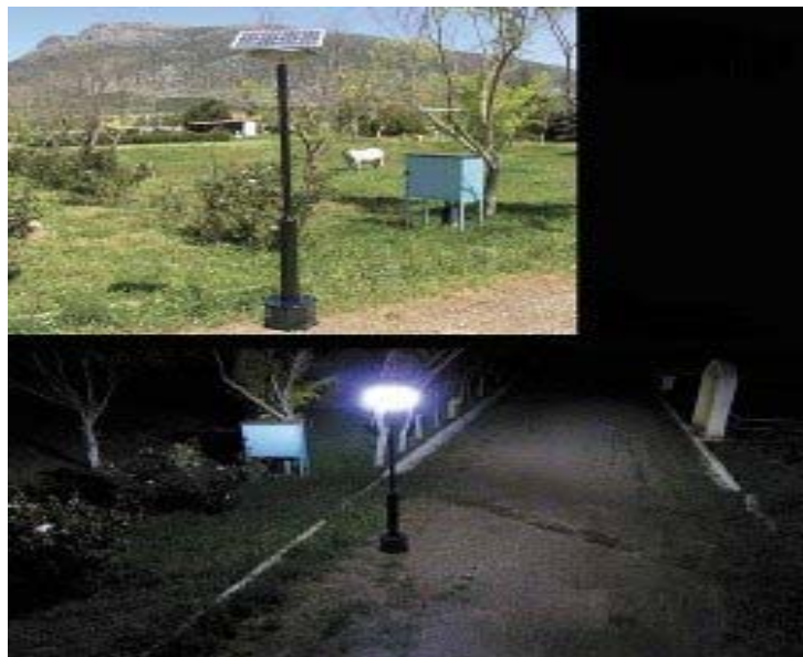
Εικόνα 26 Ύψος: 1,8-3,00m Φωτοβολταϊκό: 25W LED 30τ/μχ Battery: 55Ah Εκτ. Φωτεινότητας: 250m 2 Αντστ/για Watt: 100W Υλικό κολώνας: Αλουμίνιο
