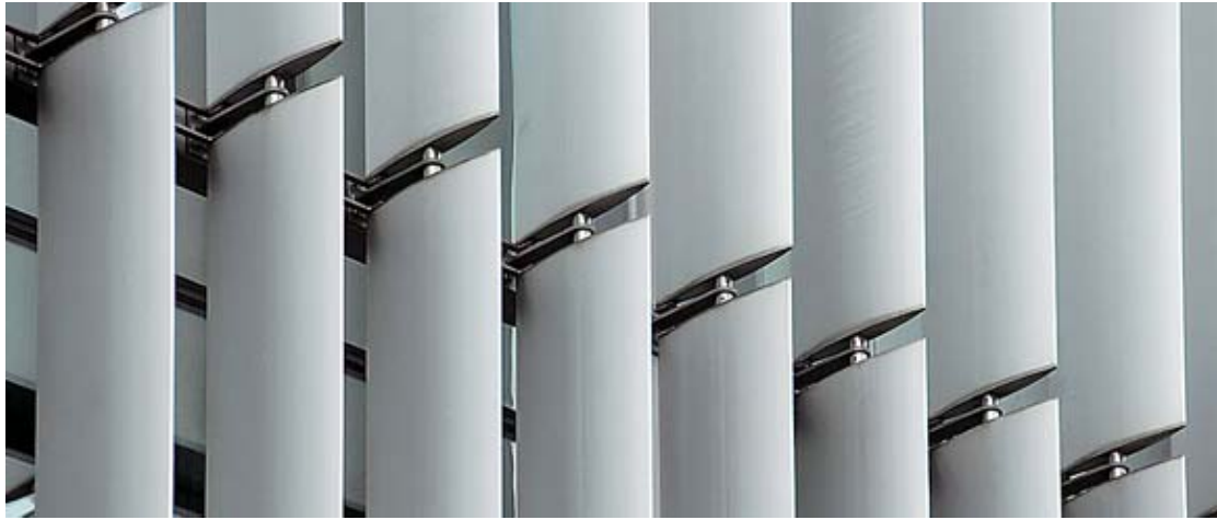
Εικόνα 11 Κινητά σκίαστρα ανάλογα με την κατεύθυνση του ηλίου
