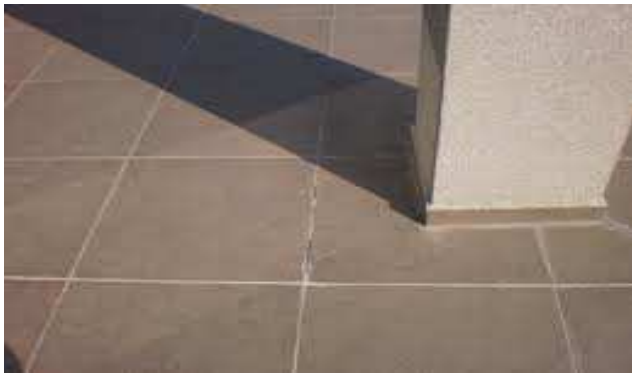
Αποσαθρωμένο τμήμα κονιάματος μεταξύ των αρμών
