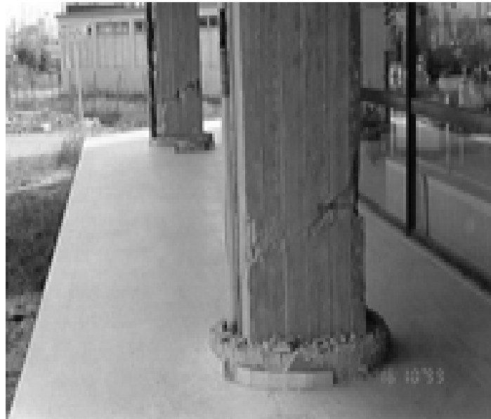
Εικόνα 1.1: Ρηγμάτωση υποστυλώματος λόγω κάμψης
