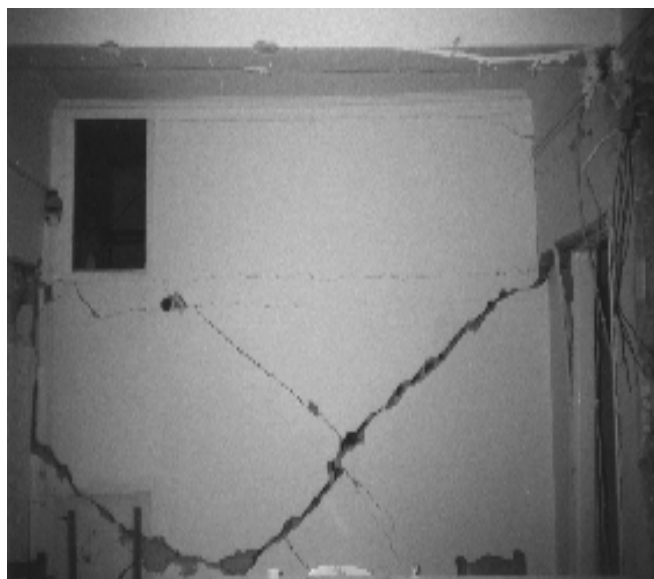
Εικόνα 1.5: Διατμητική βλάβη τοιχώματος
