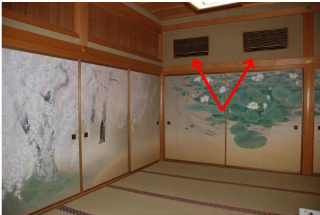
Εικόνα 28 – Σύστημα εξαερισμού πάνω σε fusuma σε σύγχρονη κατασκευή
