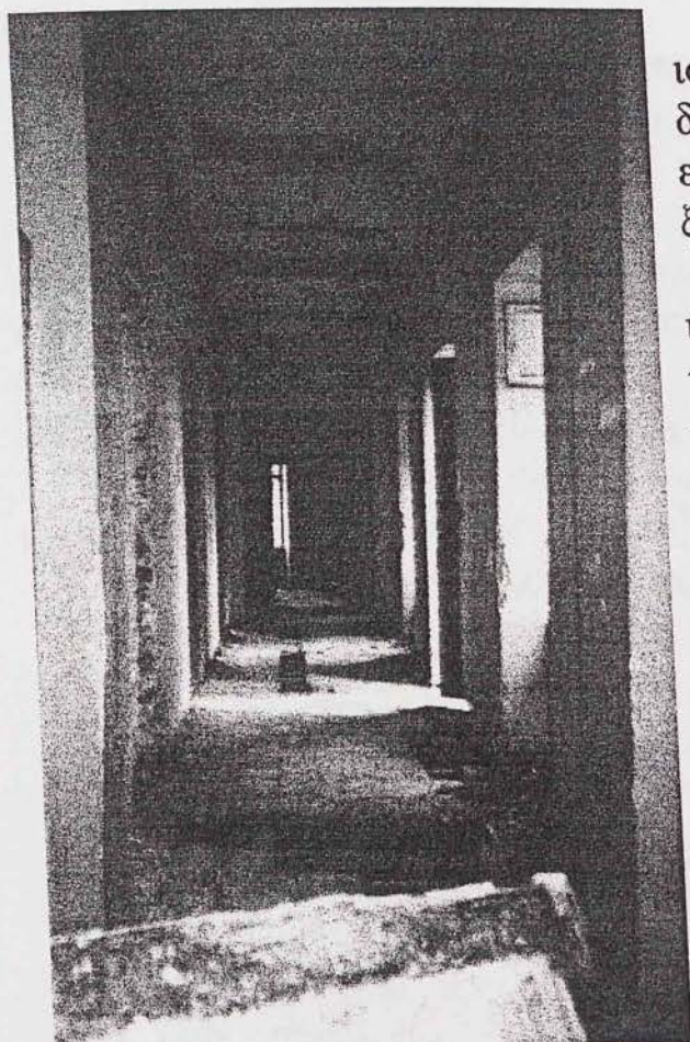
Άποψη καταστροφών στον διάδρομο
